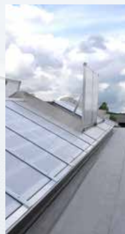
Système CI exutoire de fumées B/S
